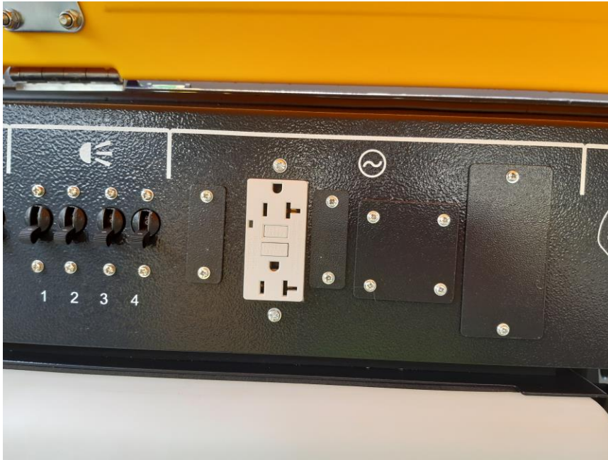
Disjuntores individuais das lâmpadas
